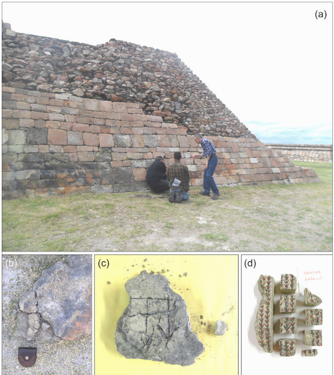
Figura 3. a) Vista de la estructura este del conjunto arquitectónico. Sobre varios de sus muros, y sobre el piso bajo estos (b), se observan evidencias de fuego. El piso es un aplanado de arcilla y cal que en algunos sectores presenta un estado de conservación bastante bueno. Nótese la marca de orientación con alineamiento N-S trazada sobre el fragmento a tomar. c) Acercamiento del fragmento objeto de estudio, previo a su tratamiento en el laboratorio. d) Vista del fragmento ya marcado sobre su superficie y parcialmente seccionado en especímenes cúbicos.
