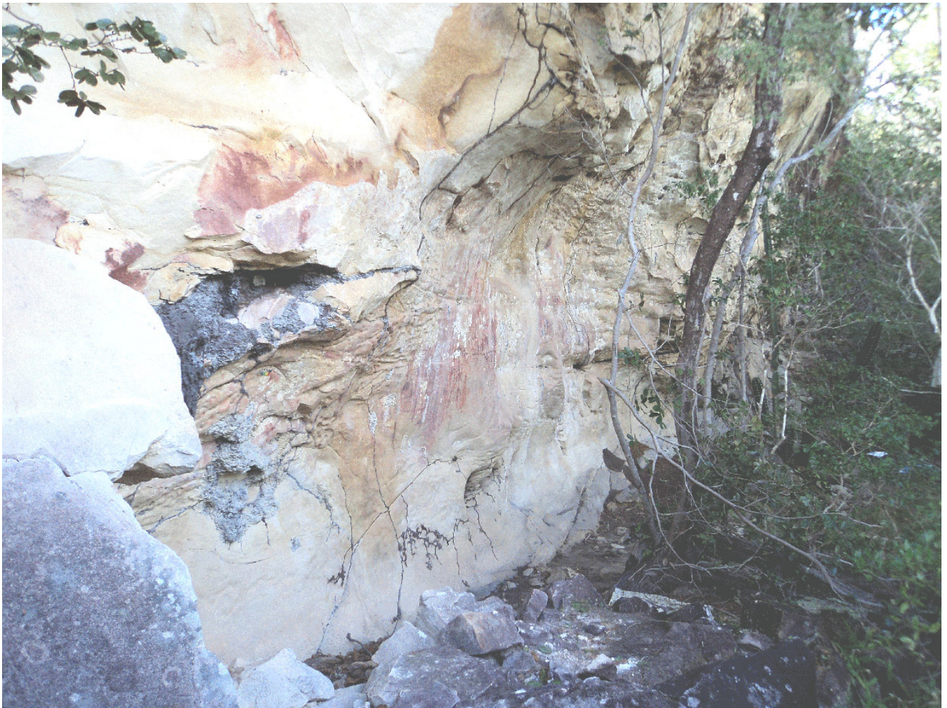
Figura 3. Vista parcial do abrigo Fazendinha I, evidenciando alguns problemas de conservação.
