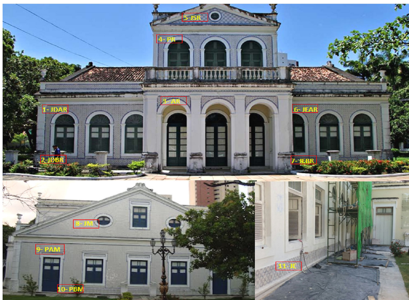
Figura 2. Mapeamento dos pontos de coleta nas fachadas de azulejos da Academia Pernambucana de Letras, Recife, Pernambuco, Brasil. 1) Janela Direita no Alto Rui (JDAR), 2) Janela Direita no Baixo Rui (JDBR), 3) Arcos Rui Barbosa (AR), 4) Porta Rui (PR), 5) Janela Superior Rui (JSR), 6) Janela Esquerda no Alto Rui (JEAR), 7) Janela Esquerda no Baixo Rui (JDBR), 8) Janela Malaquias (JM), 9) Porta no Alto Malaquias (PAM), 10) Porta no Baixo Malaquias (PBM) e 11) Janela do Estacionamento (JE).
