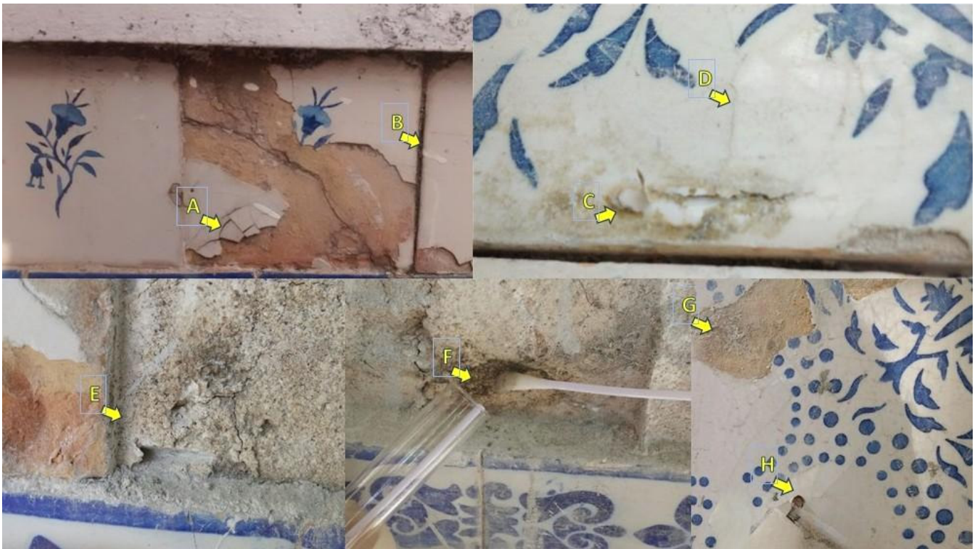
Figura 3. Detalhe do painel de azulejo da APL. Setas indicando as patologias encontradas na fachada oeste. A e C: esfoliação (desagregação com desprendimento de lâminas); B: macha preta no rejunte ; D: trinca (fissura no corpo cerâmico); E: perda (ausência de parte do azulejo); F: mancha preta aderida ao biscoito do azulejo ; G: eflorescência (depósitos brancos sobre o corpo cerâmico) e H: craquelê (microfissuras da superfície esmaltada).
